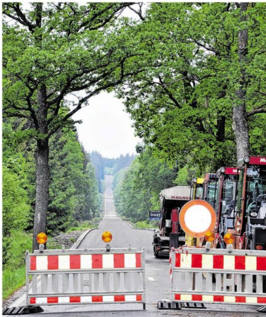
Nur noch Tragschicht und Markierungen fehlen zur Fertigstellung des komplett sanierten, fünf Kilometer langen Abschnitts der Monschauer Straße (belgische Nationalstraße N67) vor Eupen. Foto: Heiner Schepp
