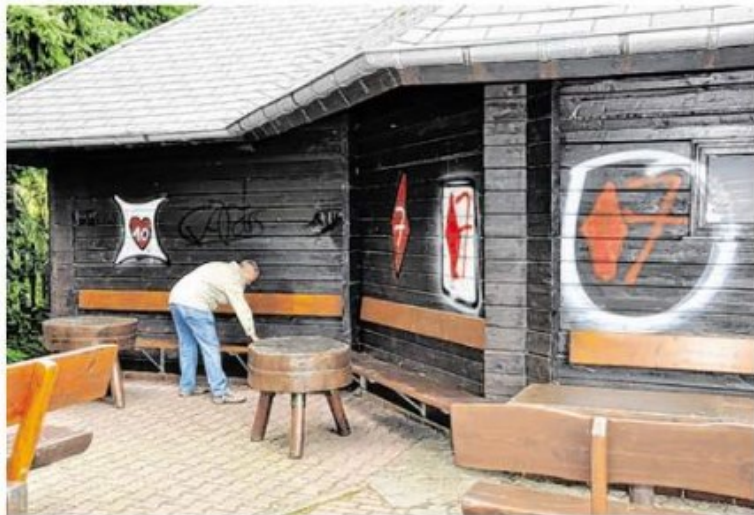
Die Grillhütte in Mützenich war am schlimmsten von den nächtlichen Sprühaktionen betroffen.
